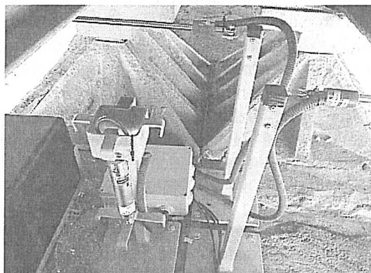
Rys. 10. Konstrukcje wsporcze do mocowania czujników kąta i czujników przemieszczeń na podporze środkowej
